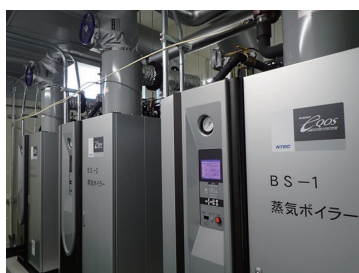
■ 蒸気ボイラー
